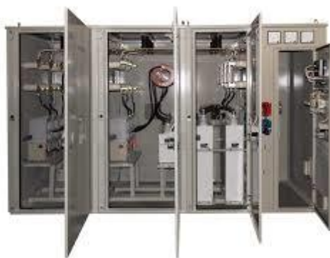
1.5—сурет – УКРМ-10,5-900 батарея конденсаторы
